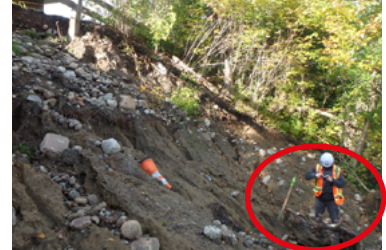
Ne pas descendre à l'intérieur du glissement
